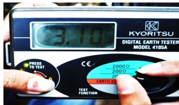
Gambar 4. Pengukuran pentanahan penangkal petir
