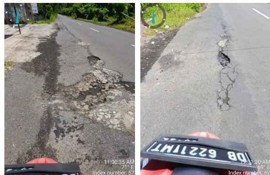
Gambar Kerusakan jalan di STA 1700 dan 1800
